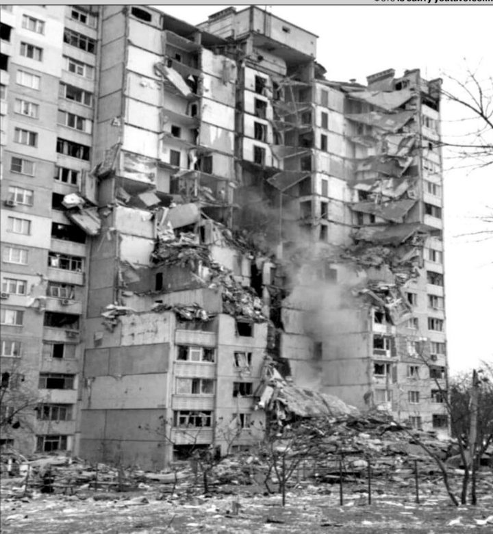
Р.С. Шістнадцятиповерховий житловий будинок на вулиці Наталії Ужвій у Харкові, який був знищений бомбою «високоточного» російського штурмовика. Льотчиків, які потрапили в полон, також на обмін, щоби продовжували ось так бомбардувати?
