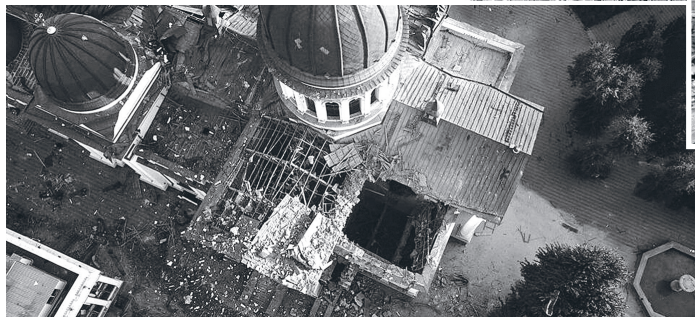
Внаслідок ракетного удару частково зруйновано будівлю храму, перекриття трьох нижніх поверхів, значно пошкоджене внутрішнє оздоблення та образи.
