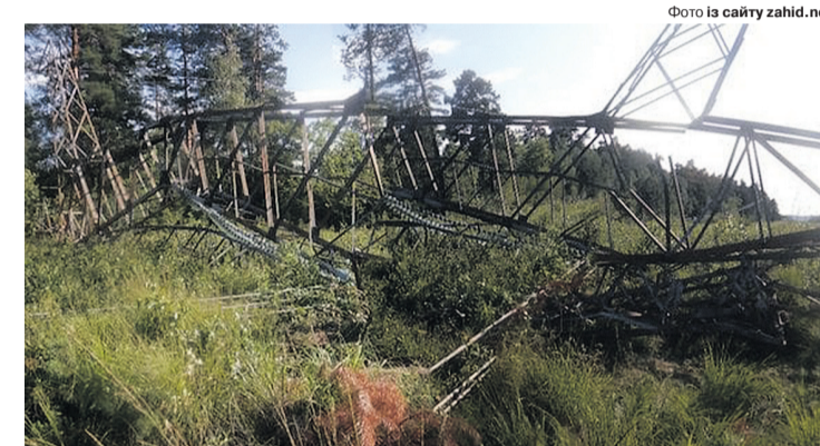
Пошкоджена електроопора впала і знеструмила кілька населених пунктів.
