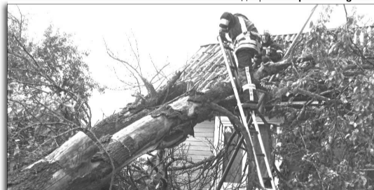
Внаслідок падіння дерева залишився пошкоджений дах будинку.
