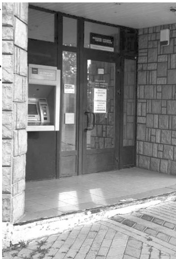
Головний вхід у приміщення відділення Ощадбанку №1000/028 в місті Горохові уже два роки поспіль «виглядає» клієнтів.
