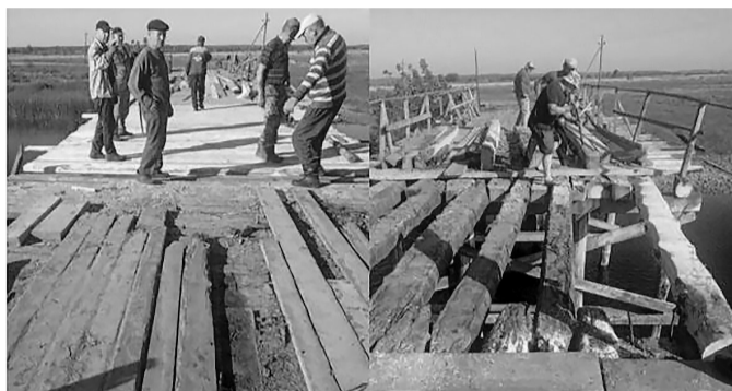
До ремонту по мосту страшно було не, що їхати, а й пішки йти.
